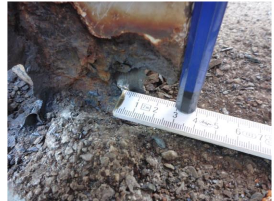
Nur noch ca. 10% ungeschädigter Stahl-Restquerschnitt
