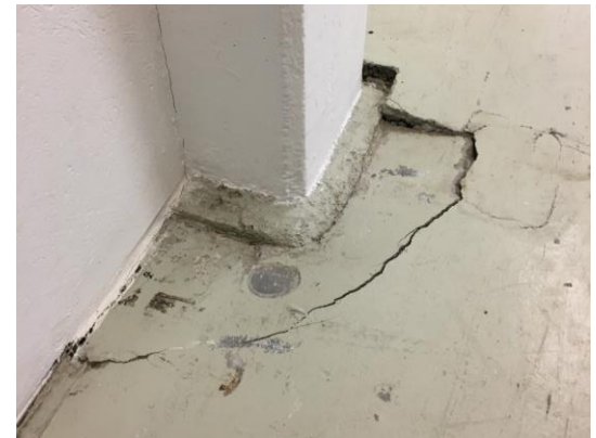
Ca. 2 cm hoher Abriss der Bodenplatte am Stützenfuß
