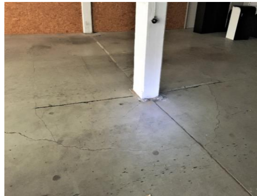
Deutliche Rissbildungen und Verformungen am "Durchstanzbereich" des Einzelfundamentes
