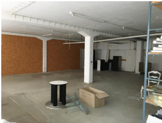
Bsp.3 Mehrgeschossige Industrieanlage: Relativverschiebungen und Rissbildungen in der Bodenplatte
