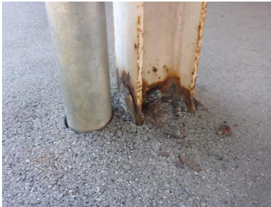
Bsp.2: Augenscheinlicher Zustand des Stützenfußes
