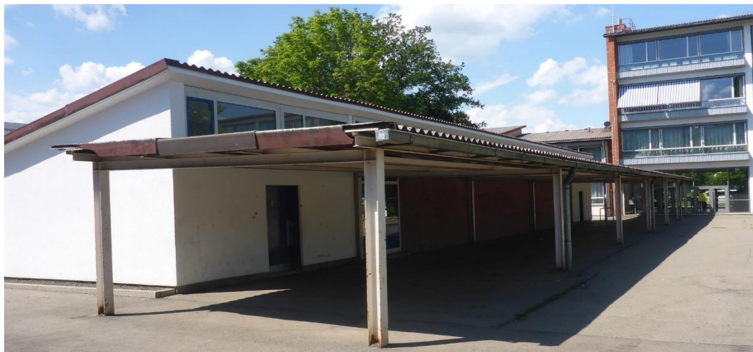
Bsp.2 Pausenüberdachung: Teilweise stark korrodierte Rahmenstützen
